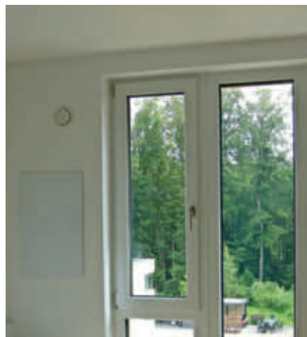
Die Komfortlüftungsgeräte befinden sich neben den Fenstern – kaum sichtbar durch eine Abdeckung.
