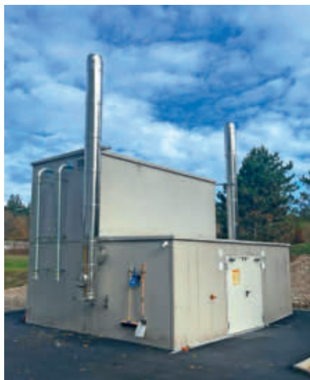
Die moderne Biomasseanlage wurde in Containerbauweise im Außenbereich des Standorts Marchtrenk aufgestellt.
