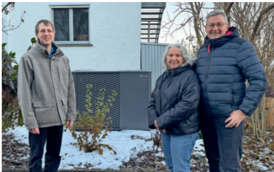
Familie Fink (rechts im Bild) gemeinsam mit Energieberater Michael Braun vom Energieinstitut Vorarlberg vor der installierten bösch Luft-Wärmepumpe MOZART beim Mehrfamilienhaus in Wolfurt.
