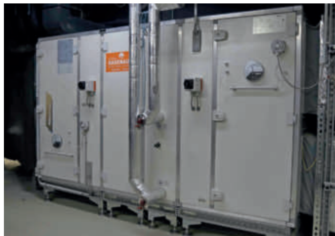
Im Technikraum untergebracht, gewährleistet das Lüftungsgerät eine energieeffiziente und kontrollierte Frischluftversorgung im Wellnessbereich.
