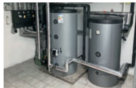
Ein Blick in den Heizraum: Pufferspeicher und Hydraulik der modernisierten Heizungsanlage.
