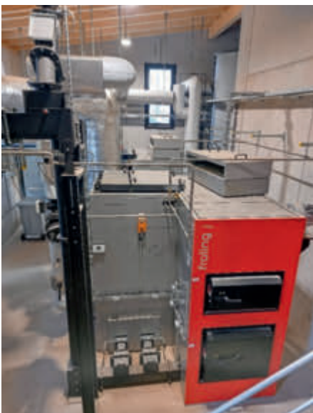
Zwei Turbomat-Hackgutkessel von Fröling beheizen mit jeweils 320 kW Leistung das gesamte Hotel – einschließlich Pool und Sauna auf rund 6.000 m 2 .
