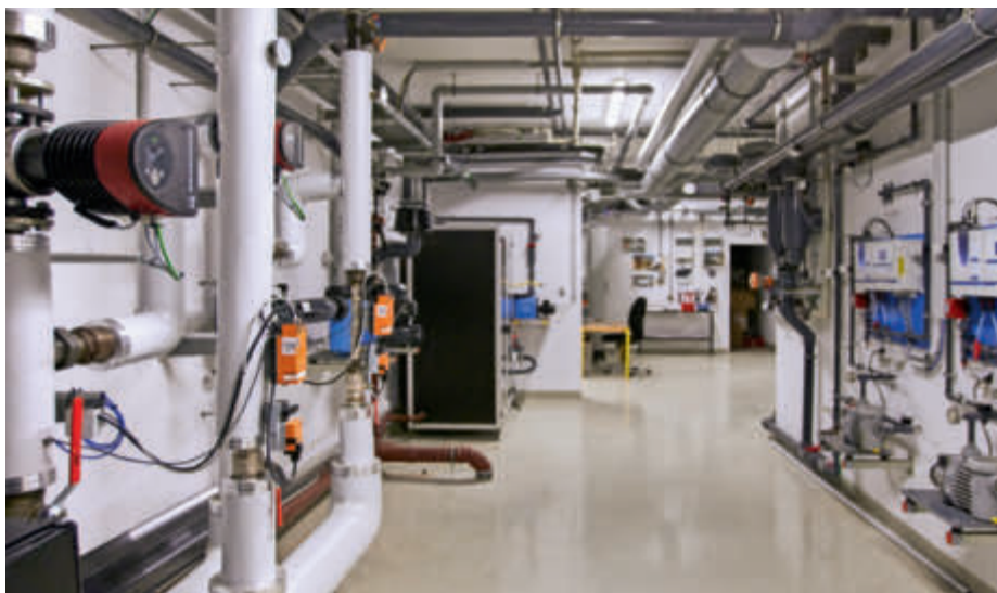
Der Technikraum im Hotel Guglwald mit Belimo Energy Valves.
