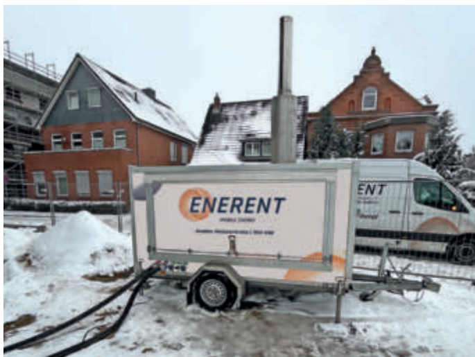
Eine mobile ENERENT Heizzentrale mit 150 kW sorgt auf der verschneiten Hotelbaustelle in Heide für die notwendige Wärme während der Wintermonate.
