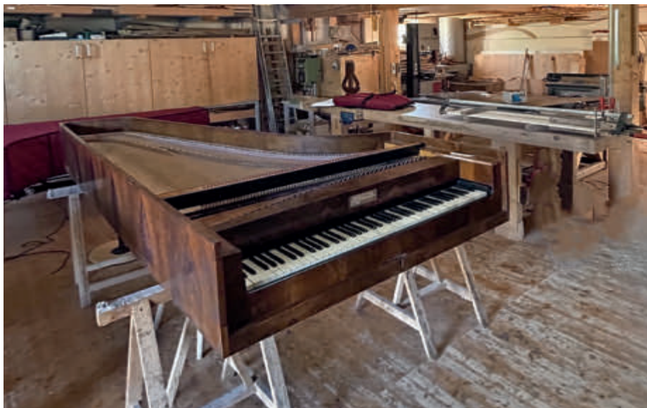
Historisches Handwerk: Die Klavier-Werkstatt Robert A. Brown Fortepianos suchte eine Lösung für konstantes Raumklima. Gefunden hat sie diese in einer Ecodan Luft/Wasser-Wärmepumpe von Mitsubishi Electric.
