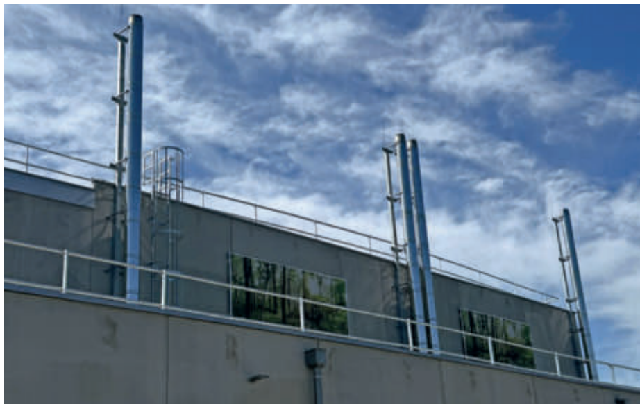
Das Projekt in Hinzenbach zeigt, wie Biomasse-Heiztechnik und Abgastechnik zusammenspielen – durch vier Hackschnitzelkessel von ETA Heiztechnik und vier abgestimmte NiroLine DW Abgasanlagen von Stocker.
