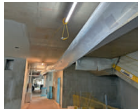
Das Warmluftschlauch-System verteilte insgesamt zwei Megawatt Wärme im gesamten Gebäude.
